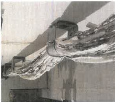
Bild 4: Durchhang der Kabel nach einer Brandbelastung von 90 Minuten
