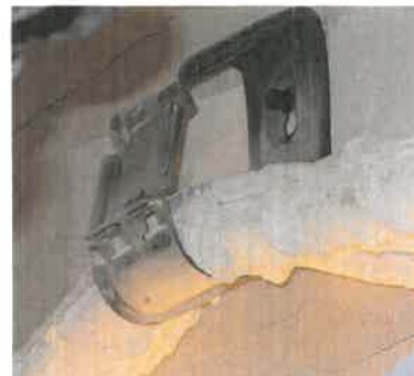
Bild 3: Verformung bei Wandmontage
