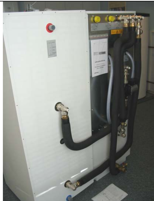
Aufstellung Warmwasserspeicher rechts
