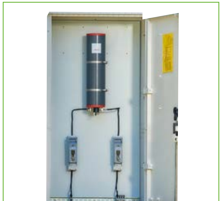
Fig. 4 Montage im Verteilerschrank
