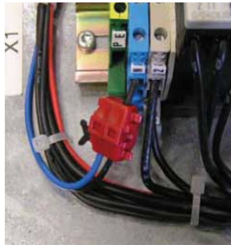
Fig. 1.7: 5) Notez les modifications sur les documents de câblage
