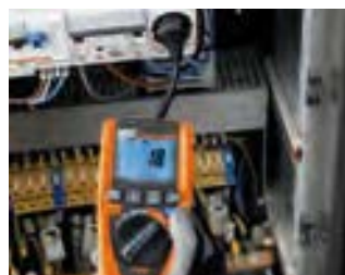
Impedanzmessung ohne RCD-Auslösung
